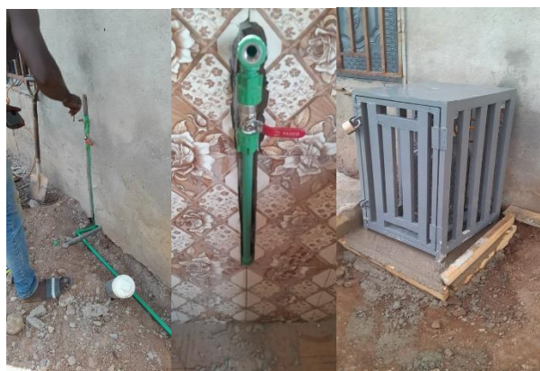
Gasleitung an der Wand, Gasanschluß und der Gitterkäfig dazu
